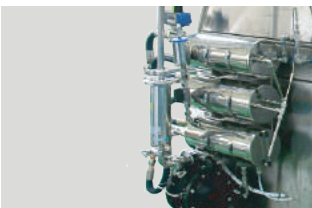
비가동시 원료의 고형화 방지를 위한 용액(Solution) 저장 탱크 및 자동밸브 장착
